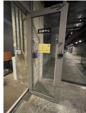
N303 自學中心大門地絞鏈故障更新 (夾傷危險)
