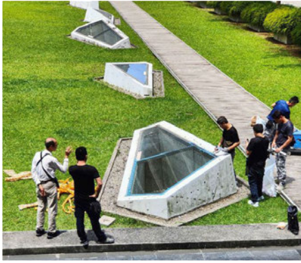
圖書館草坪右側採光罩玻璃破損更新 (砸傷危險)
