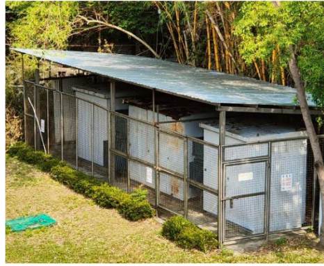
G 棟變電站高壓電機房浪板破損更新 (漏水感電危險)
